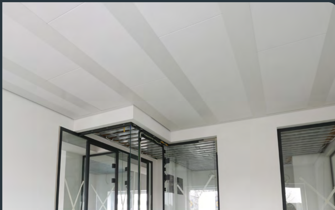
Klimadecke mit integrierter Beleuchtung
