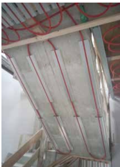
Einfamilienhaus mit Klimadecke bis ins offene Treppenhaus.
